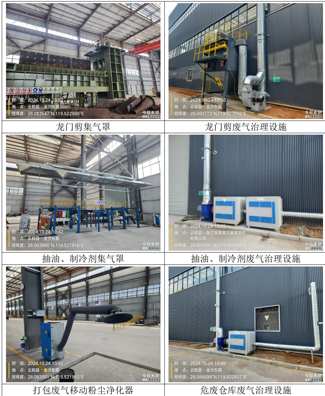
图 5.2-1 废气产污节点和处理设施现场图
