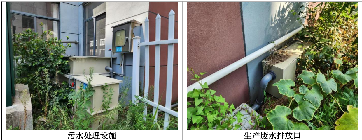
图 3-1 废水处理设施现场图
