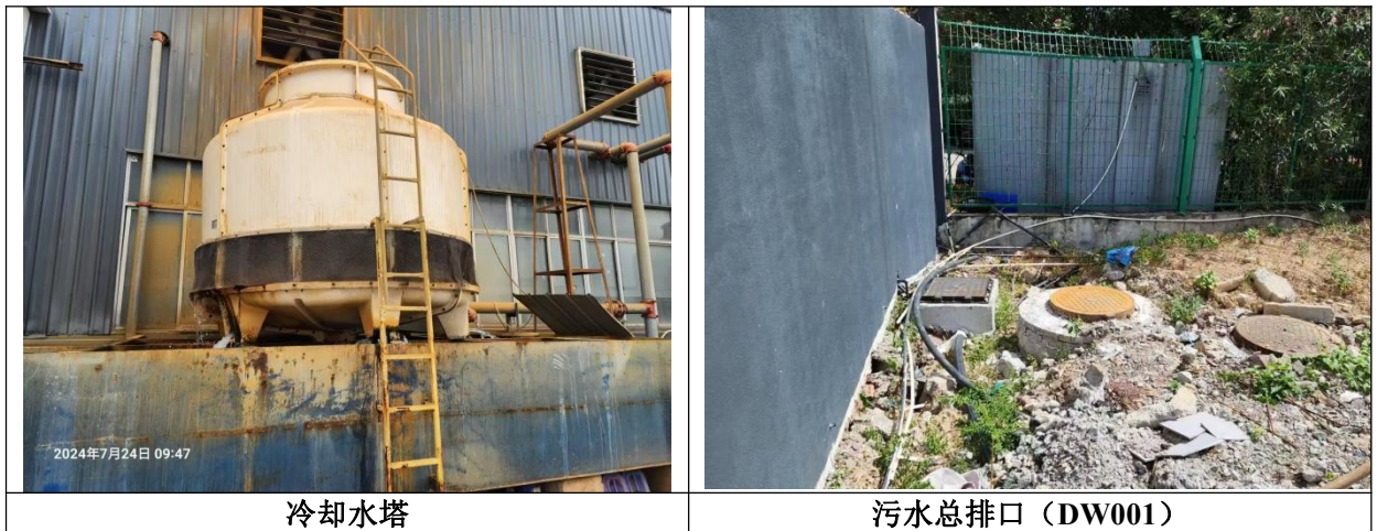
图 3-1 废水处理设施现场图
