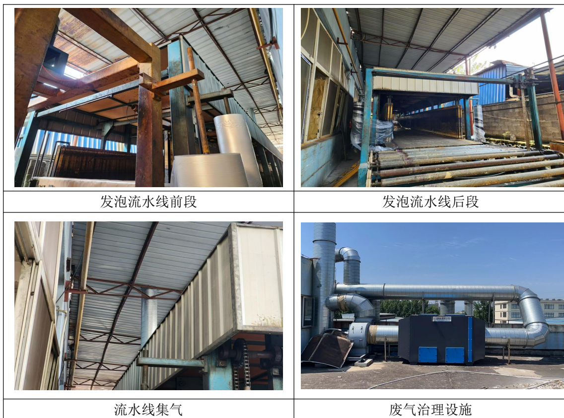
图 5.2-1 废气产污节点和处理设施现场图
