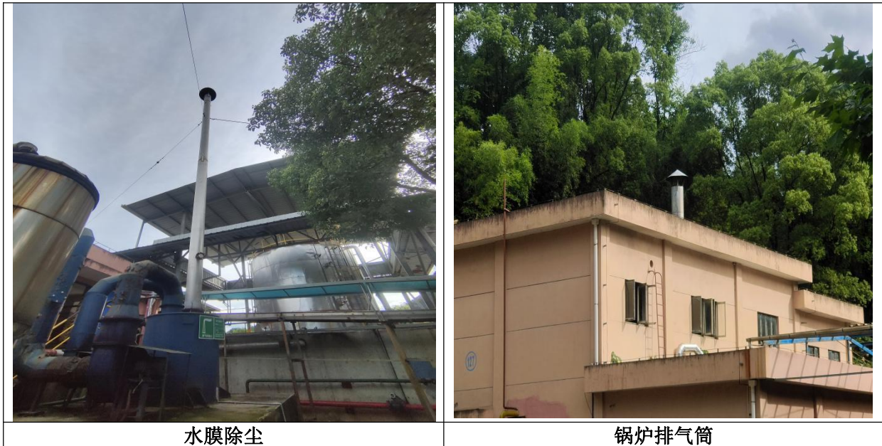
图 3-1 废气处理设施现场图
