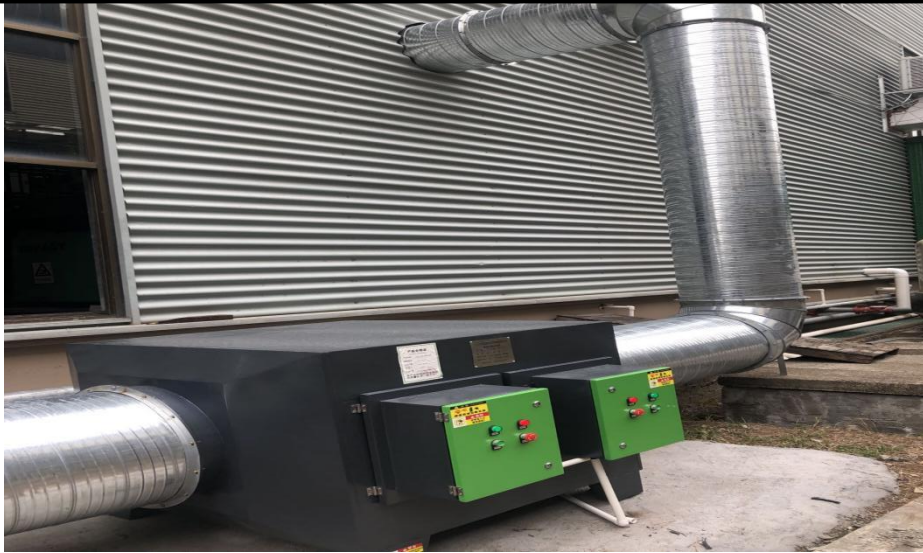
废气处理设施
