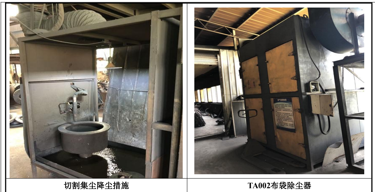
图 4-2 废气治理现场情况
