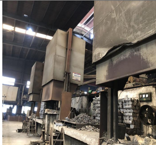
中频电炉集尘措施
