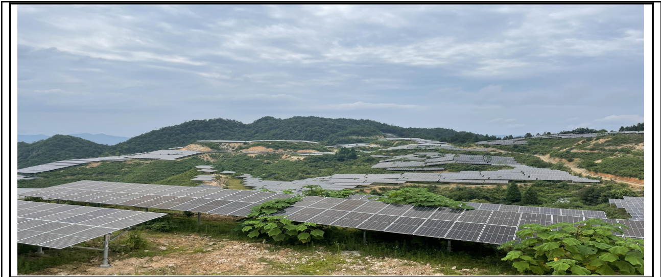
图 2-1 部分光伏区现场图
