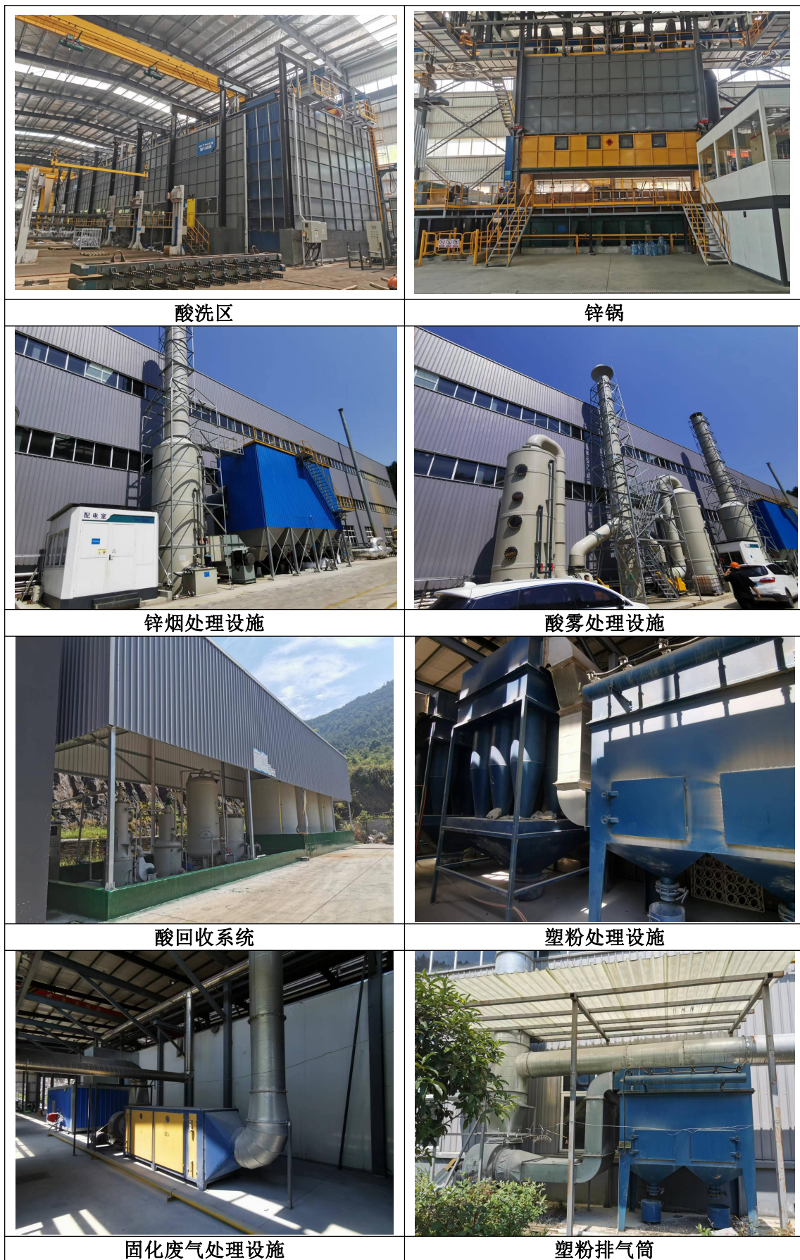
图 5.6 热处理线产污节点和处理设施现场图
