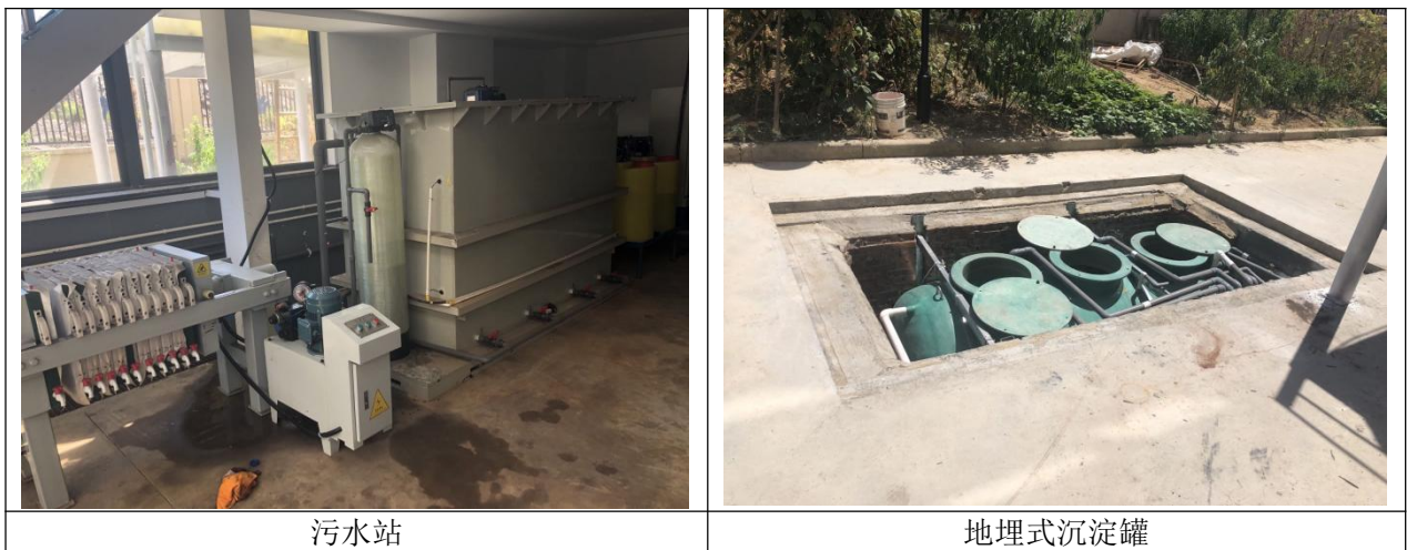
图 4-3 废水处理设施
