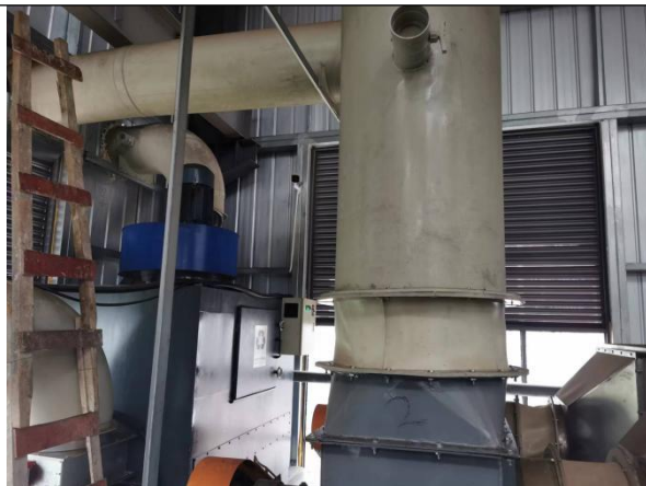
油雾净化器及排气筒
