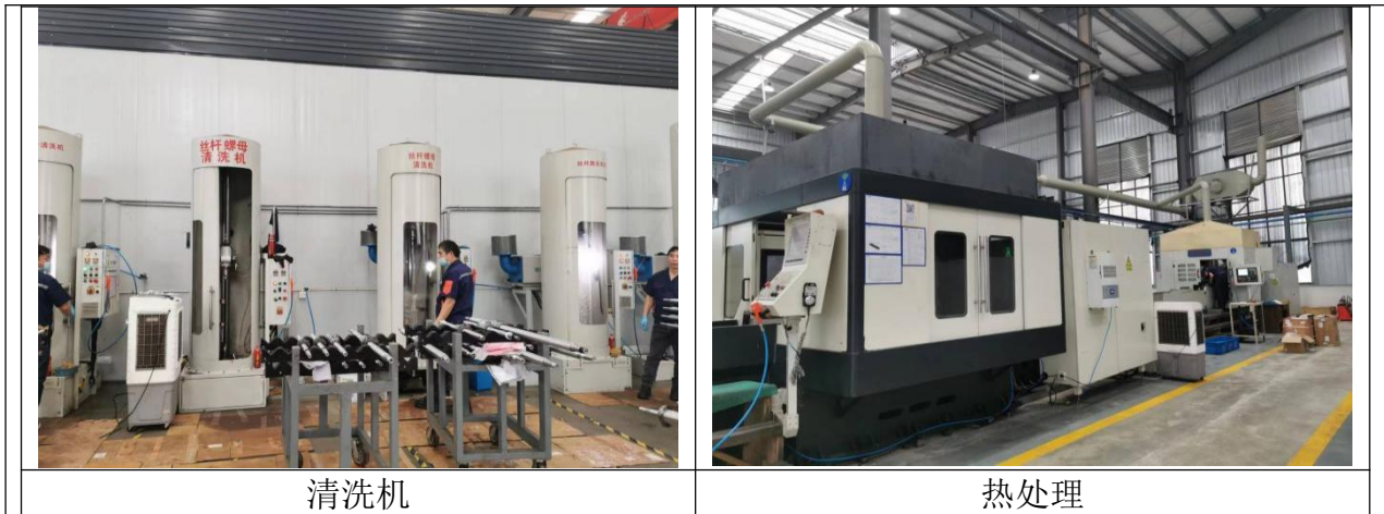
图 3-2 项目废气产污结点和处理设施现场图
