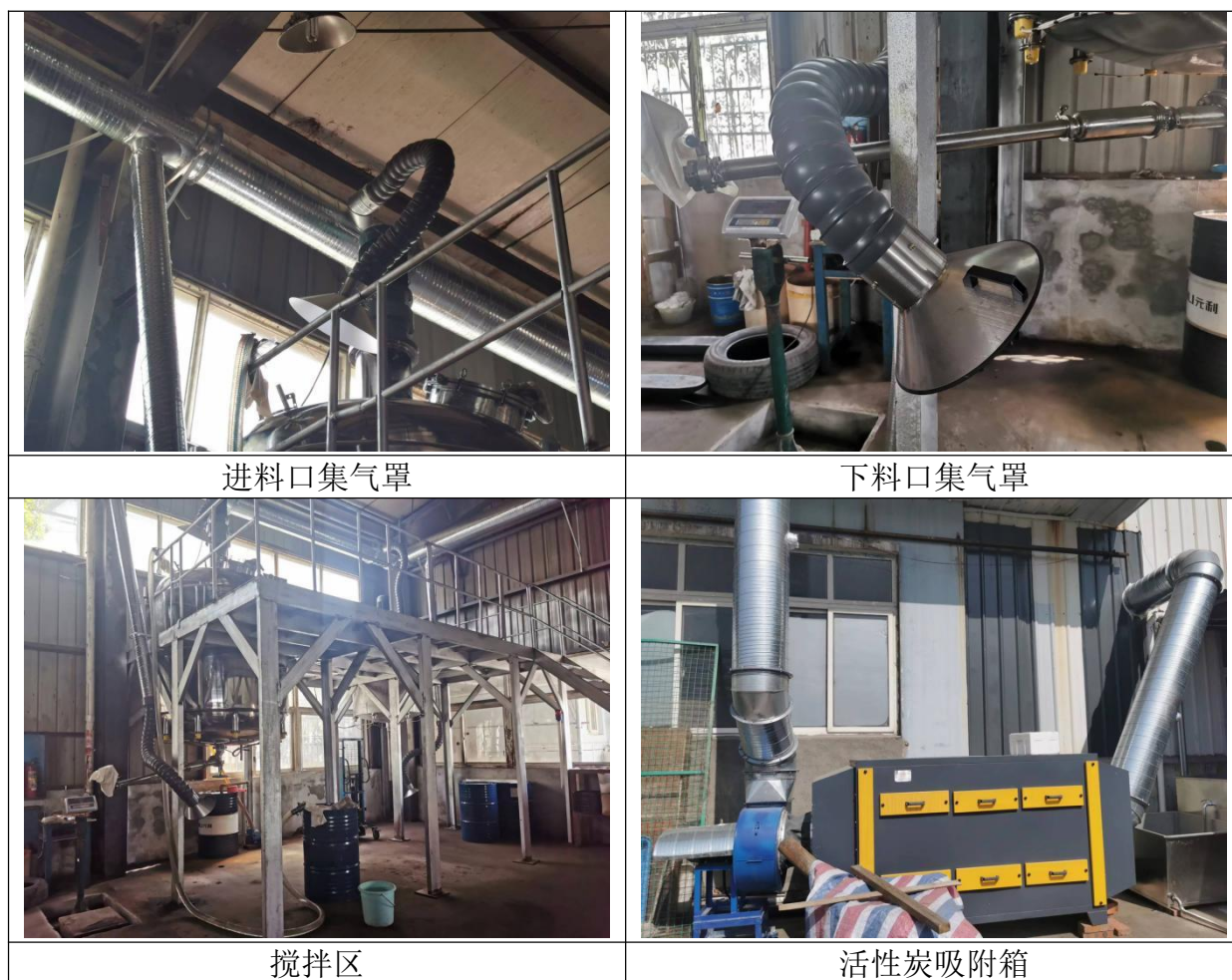
图 3-2 项目废气产污结点和处理设施现场图
