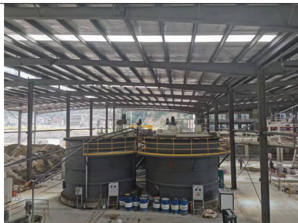
浆料储罐现场图
