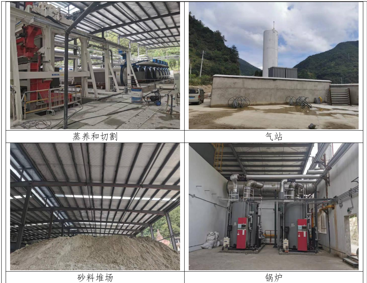
图 3-3 废气产污节点和处理设施现场图
