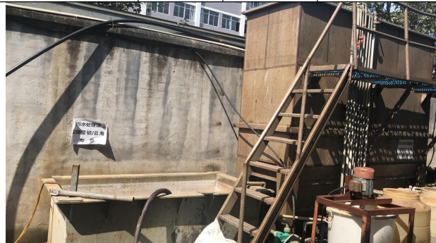
FS1#排放口一废水处理设施
