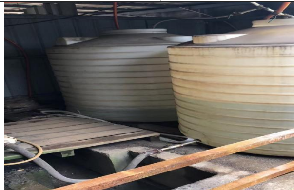
FS2#排放口一沉淀设施
