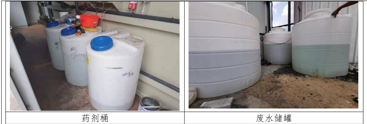
图 4-1 污水处理设施现场图
