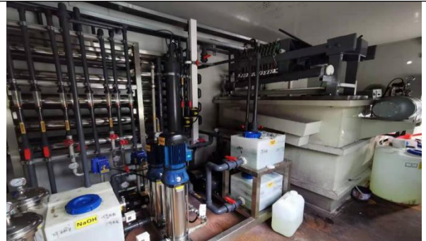
污水处理设施
