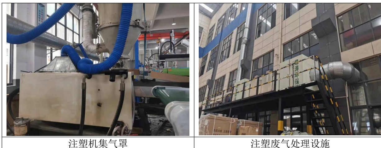
图 3-1 注塑废气产污结点与处理设施现场图
