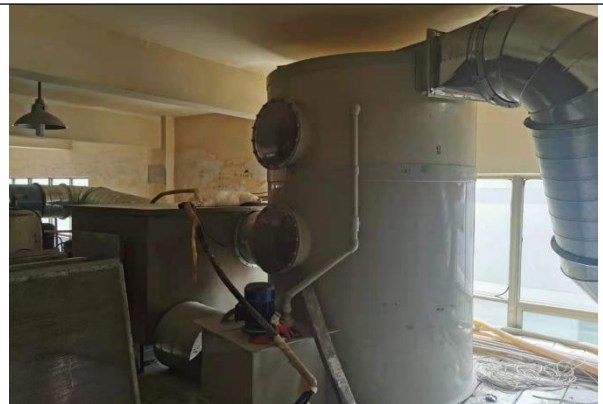
废气末端治理设施现场图
