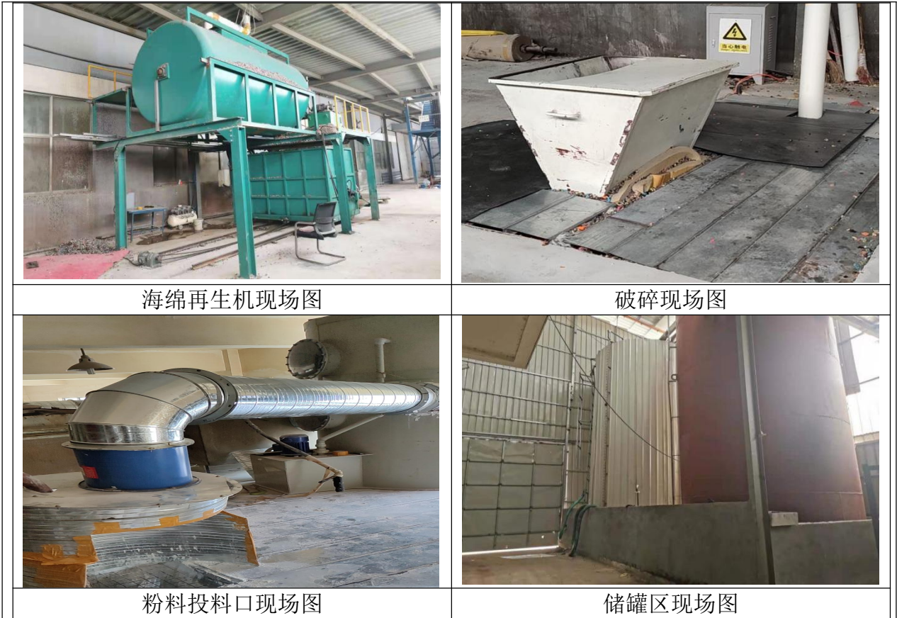
图 3-1 废气产污结点和处理设施现场图处理设施
