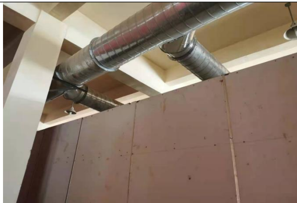
废气收集管道现场图
