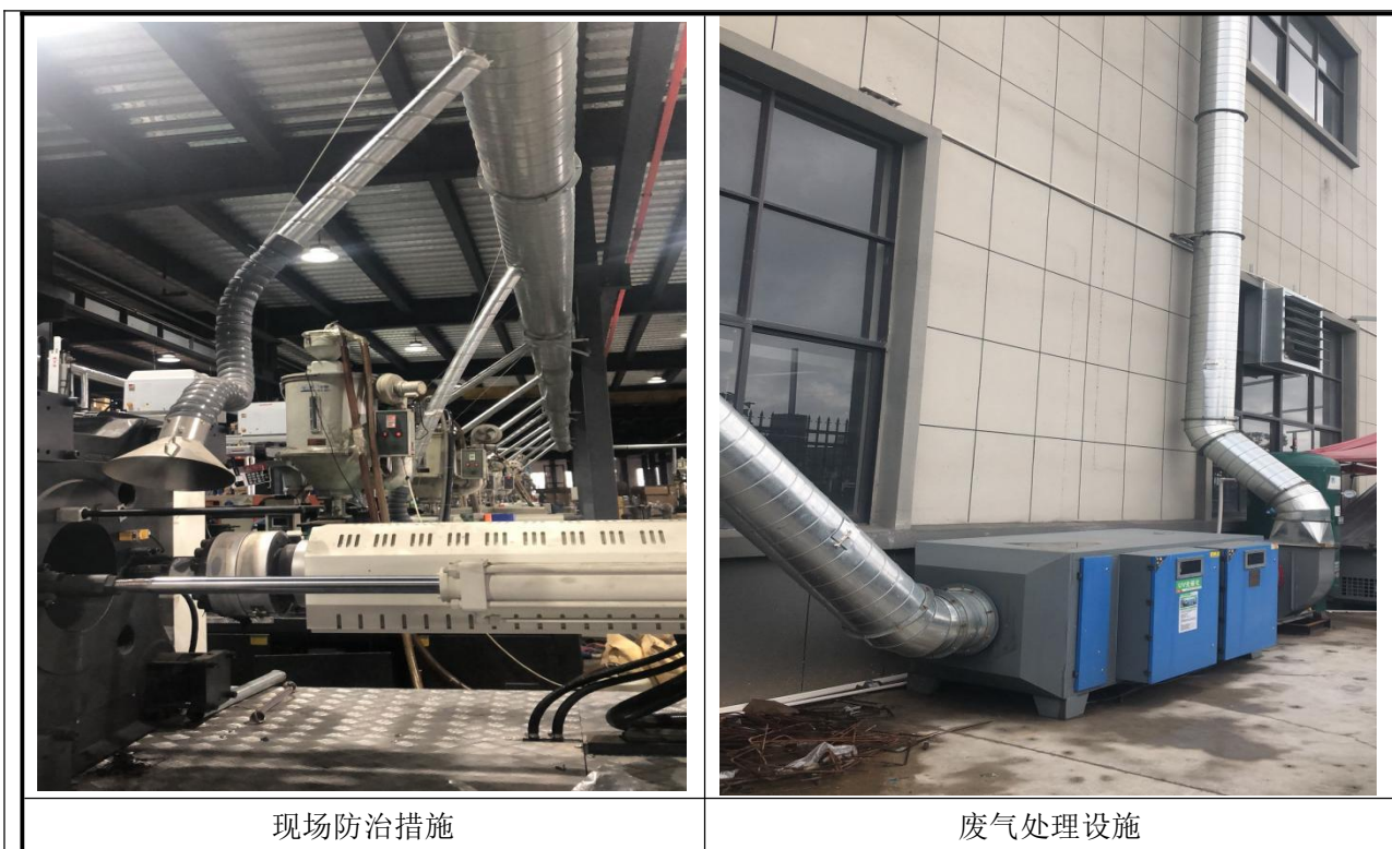
图 4-2 项目废气治理情况
