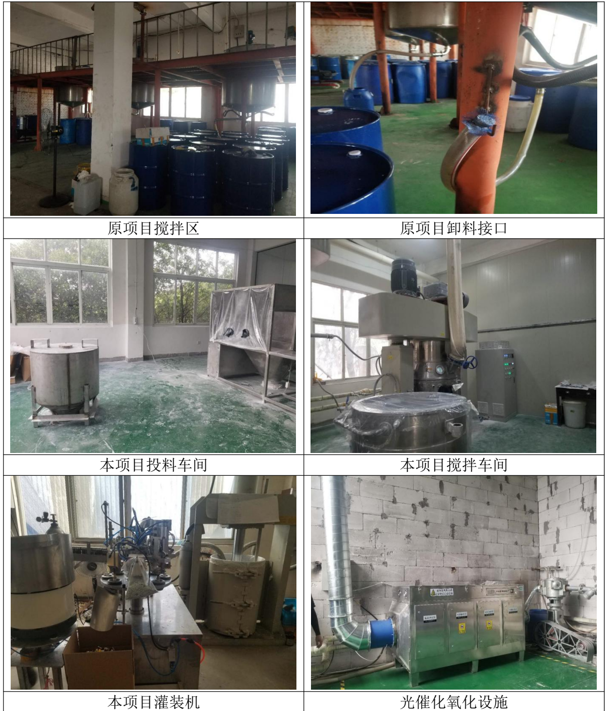
图 3-3 废气产污节点和处理设施现场图处理设施
