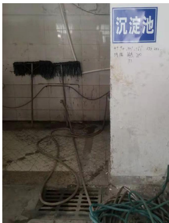
图 3-1 沉淀池现场图
