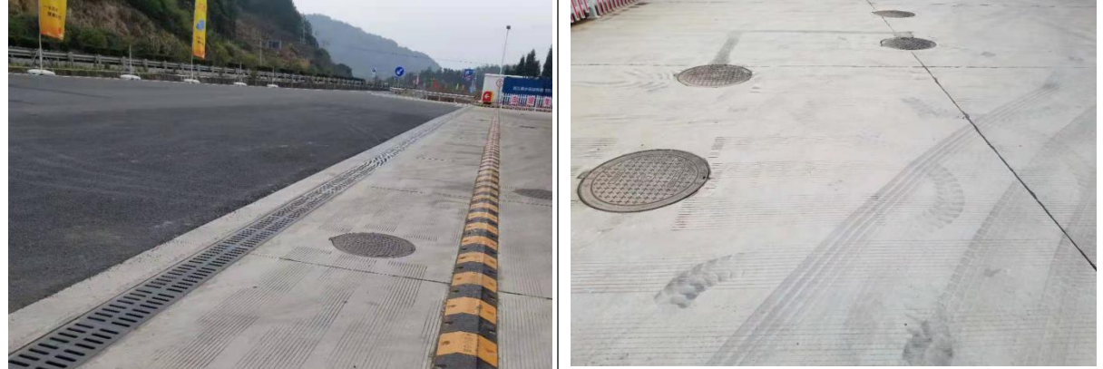
图 3-2 项目雨水收集和隔油池现场图
