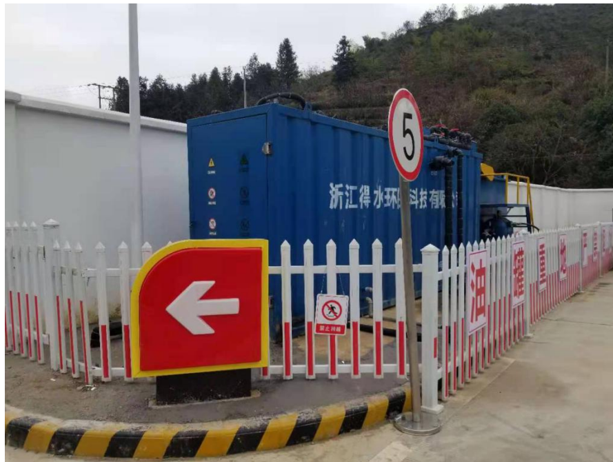
图 3-4 集装箱污水处理设施现场图
