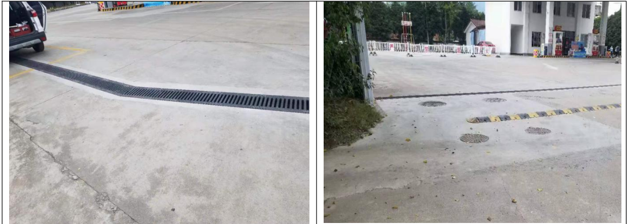
图 3-2 项目水封装置现场图
