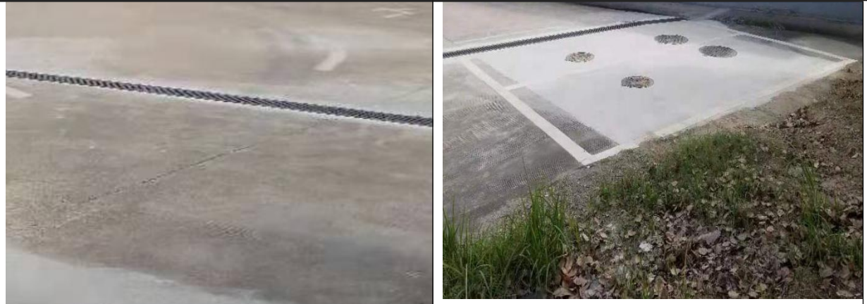
图 3-2 项目水封装置现场图
