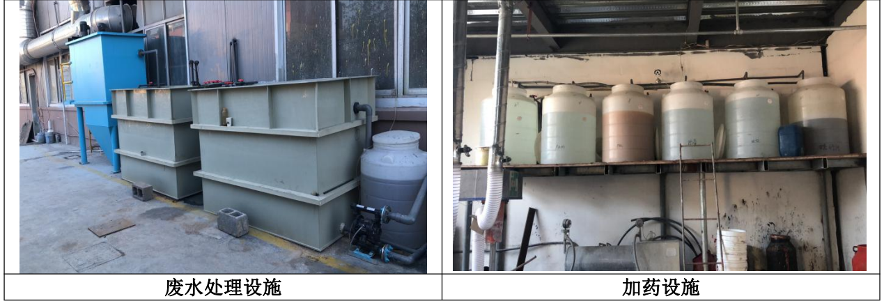
图 4-1 项目生产废水处理设施现场图
