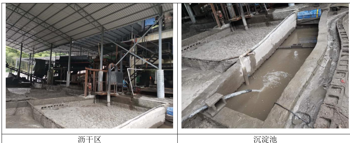
图 3-1 沥干、沉淀区现场图
