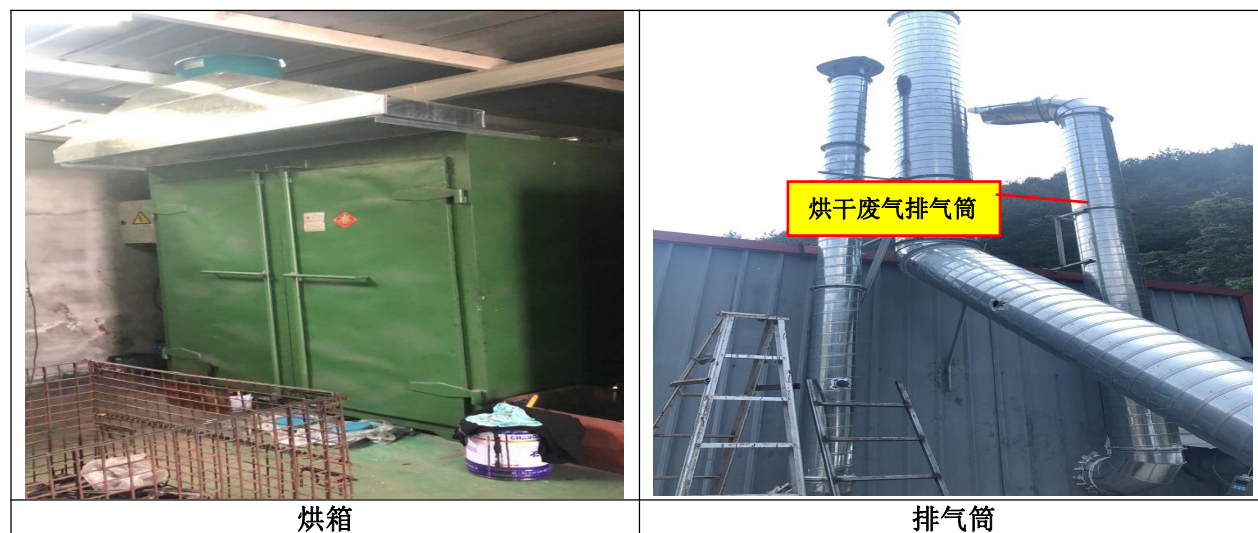
图 4-5 项目烘干废气收集处理措施
