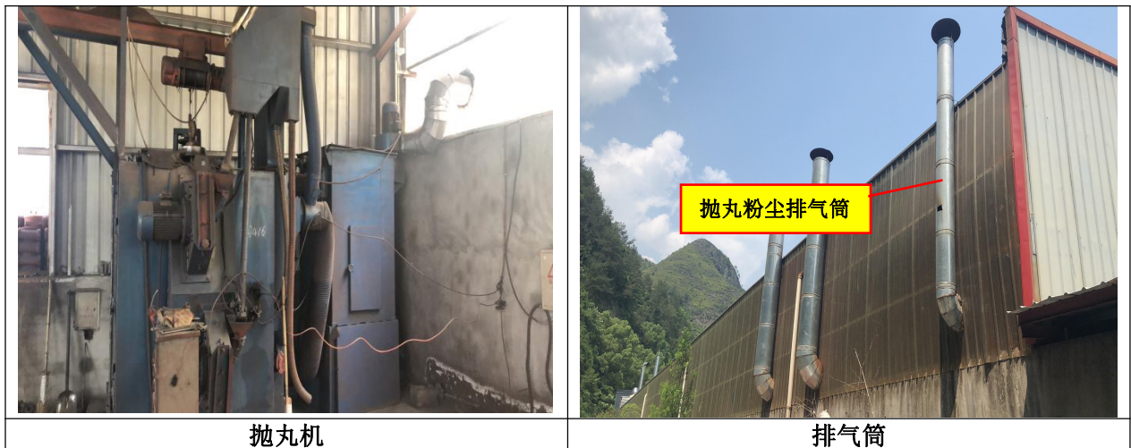
图 4-3 抛丸粉尘废气收集处理措施
