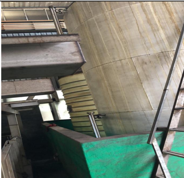
储罐贮存防治措施、围堰
