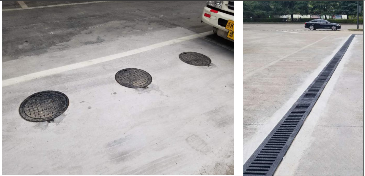
图 4-2 项目雨水收集池隔油池现场图
