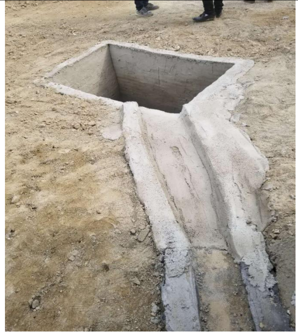
车间外小型收集池
