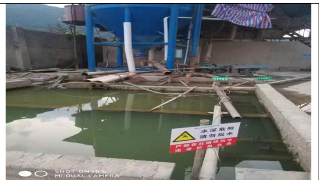
废水收集处理池
