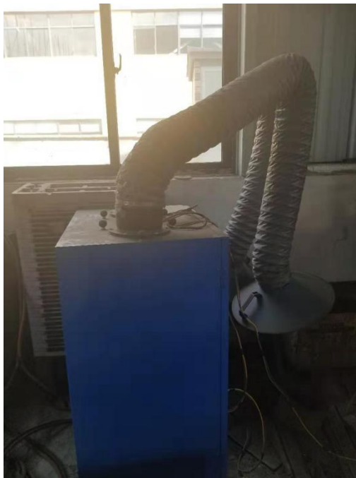
图 4-3 废气处理设施现场图
