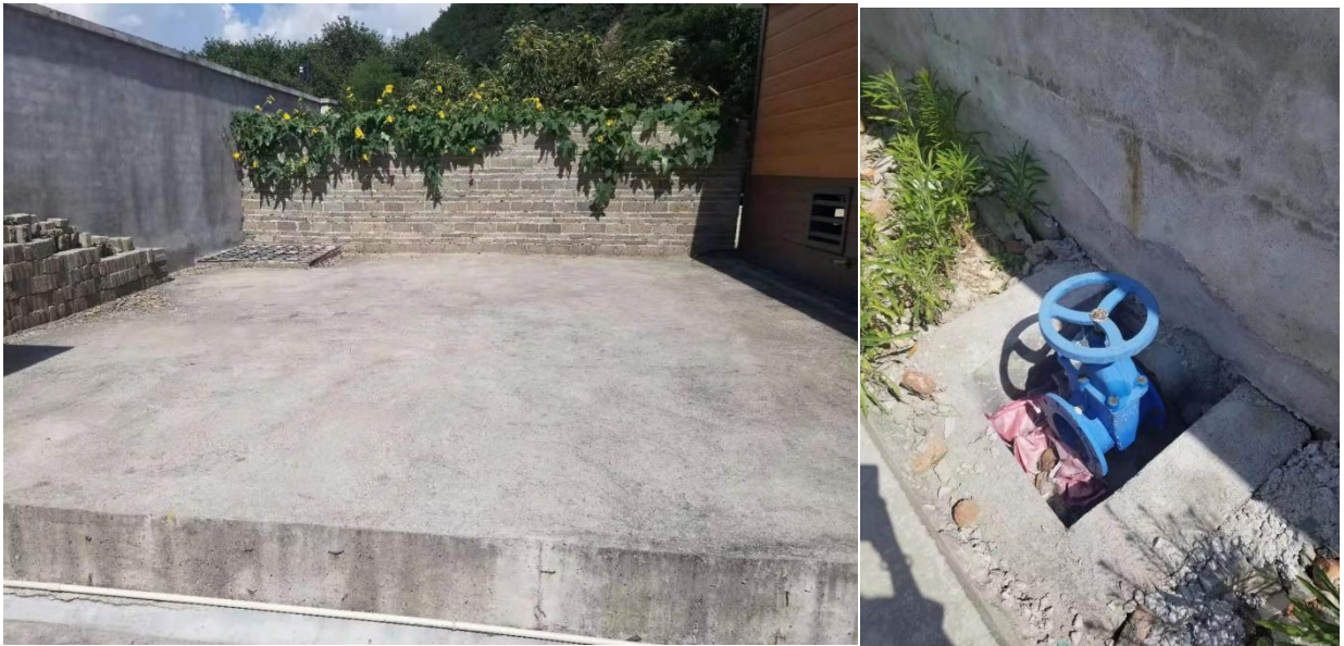
图 4-2 应急池及阀门现场图
