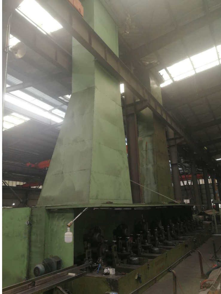
图 4-2 水喷淋除尘器现场图
