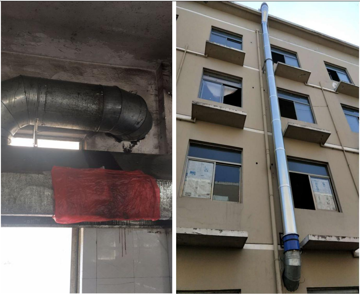
油烟净化设备现场图
