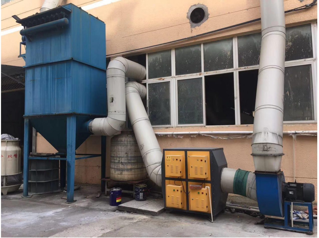
图 3-2 废气治理设施图
