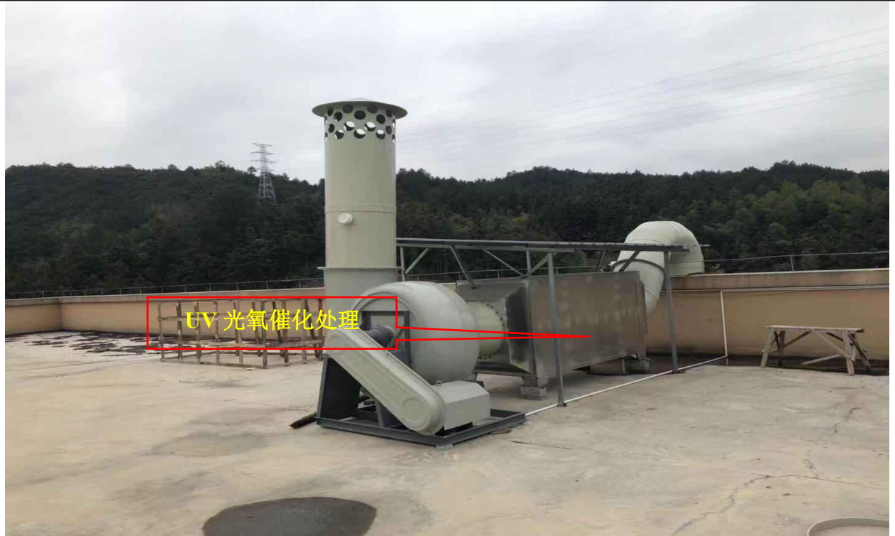
图 3-4 项目油漆废气治理现场情况
