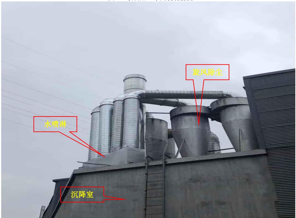
图 3-7 项目粉尘治理现场情况
