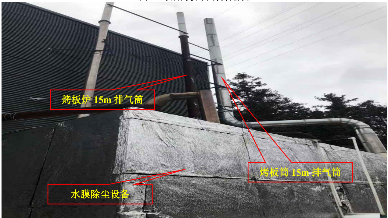
图 3-9 项目烤板车间治理现场情况
